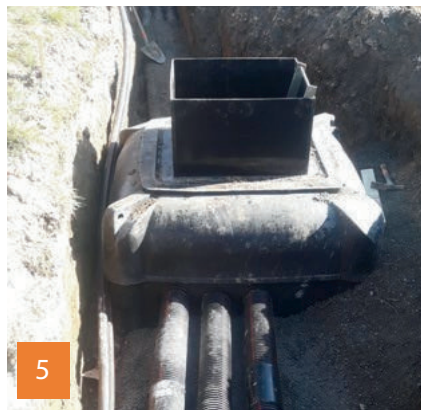
5 Teilweise gefüllter Schacht.
